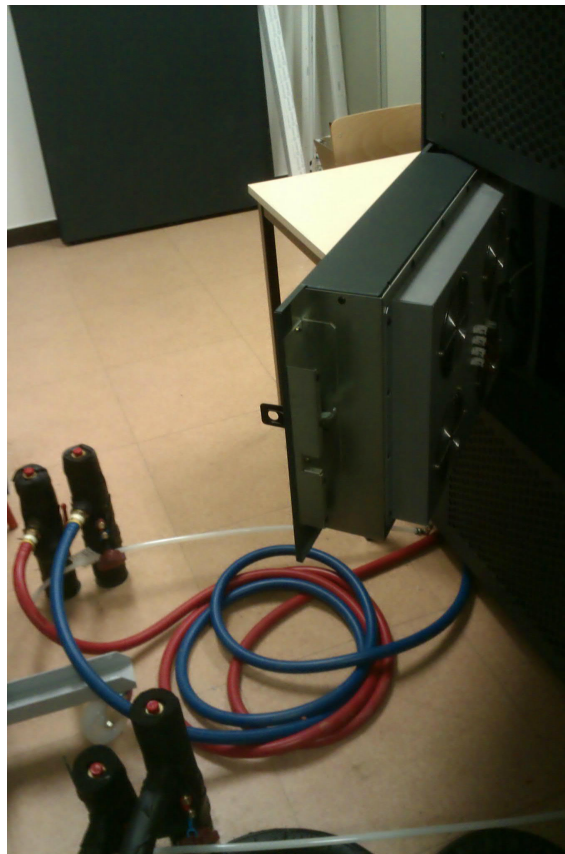
Vue face Arrière avec branchements sur les attentes
